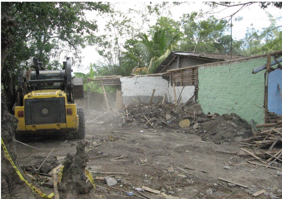
Fotografia 5: Destruição de casa por trabalhadores da Emgesa, San José de Belén (Agrado) (2013).
